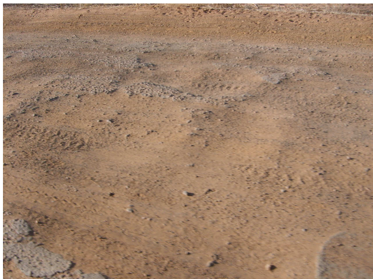
Photo 14 : état dégradé de la principale route bitumée (axe Mirriah-Guidimouni)
