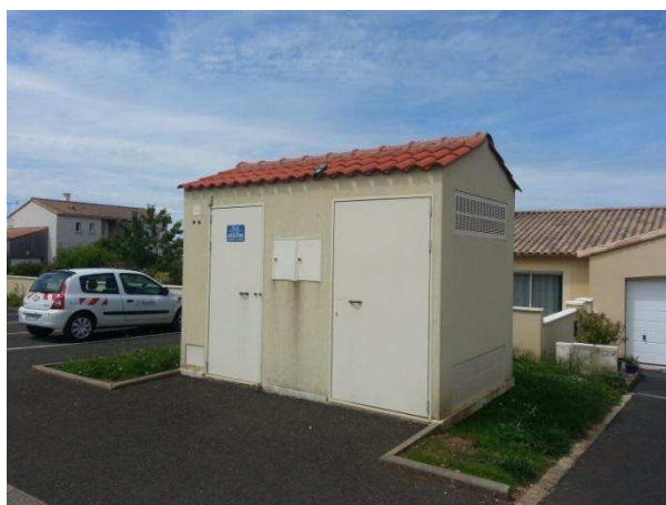
Figure 4.25 : Poste HTA/BT type maisonnette en parpaing
