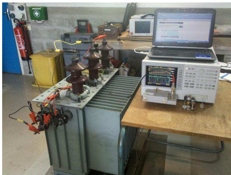
Figure 2.59 : Illustration du raccordement de l'analyseur d'impédance à un transformateur de distribution
