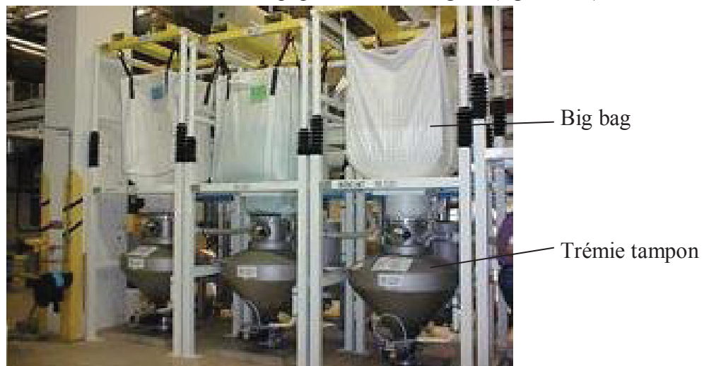
Figure 4.6 : Déchargeur « big-bag » avec trémie tampon[25]
